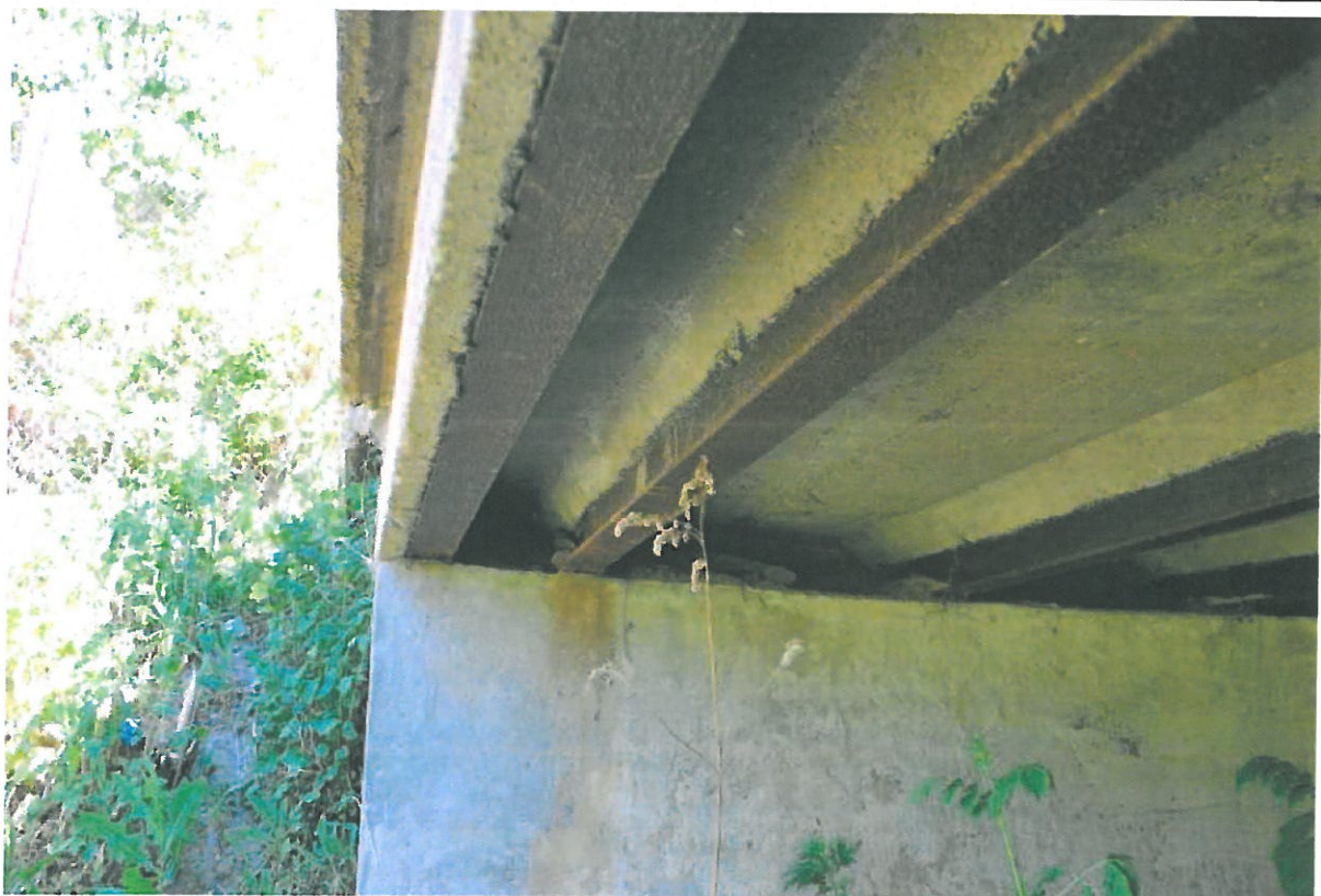
Fot. 6. Widok na przyczółek północny od strony zachodniej. Widoczne rdzawe zacieki wskazujące na nieszczelności powierzchni w strefie dylatacji.
