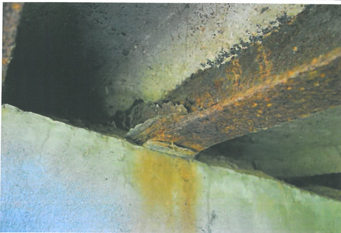
Fot. 8. Widok na drugą belkę od strony północno – zachodniej. Widoczne zniszczenie struktury materiału dźwigara spowodowane zaciekami wody z nieszczelnej nawierzchni w strefie dylatacji.
