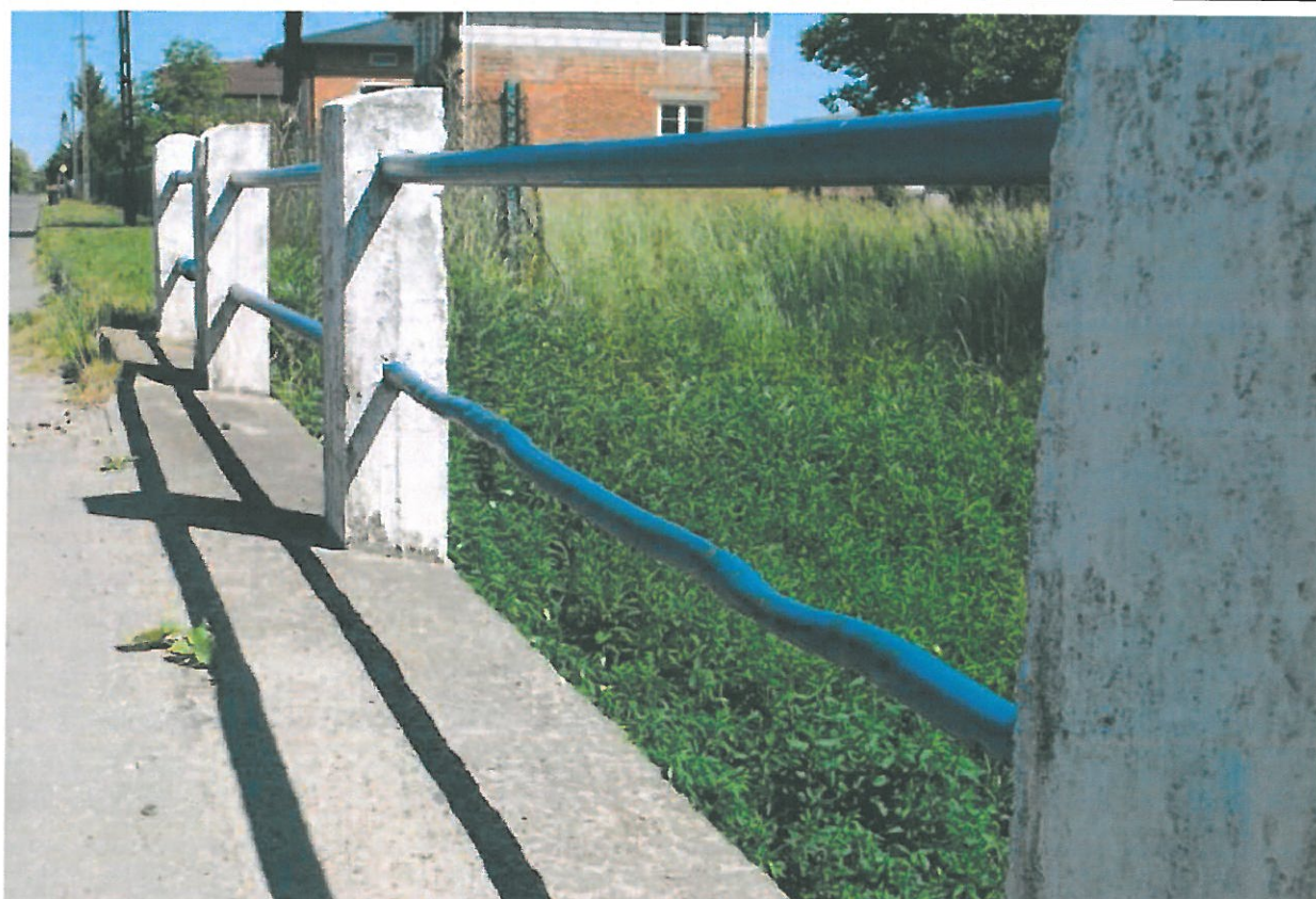
Fot. 16. Widok na balustradę po stronie wschodniej. Widoczne deformacje przeciągów.
