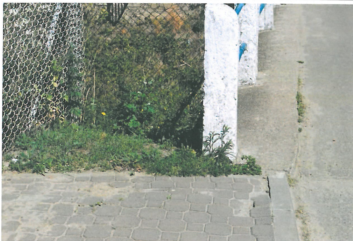
Fot. 18. Widok na dojście do mostu od strony południowo - zachodniej. Widoczny brak kontynuacji chodnika na obiekcie.
