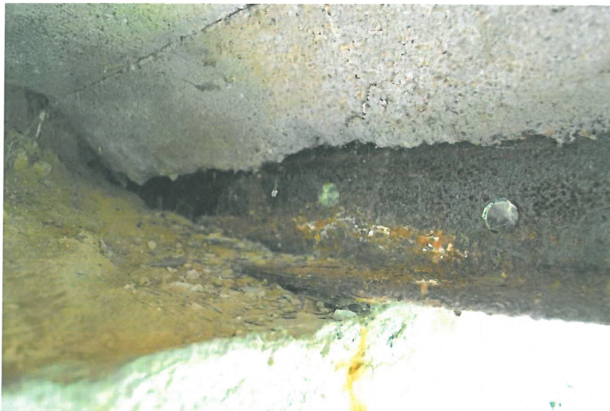
Fot. 9. Widok na dźwigar po stronie północno - wschodniej. Widoczne zniszczenie struktury materiału belki powstałe w wyniku utrzymywania wilgoci na zanieczyszczonej ławie podłożyskowej przyczółka.
