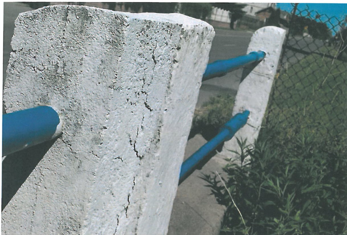
Fot. 17. Widok na rysy betonu słupka balustrady wschodniej.
