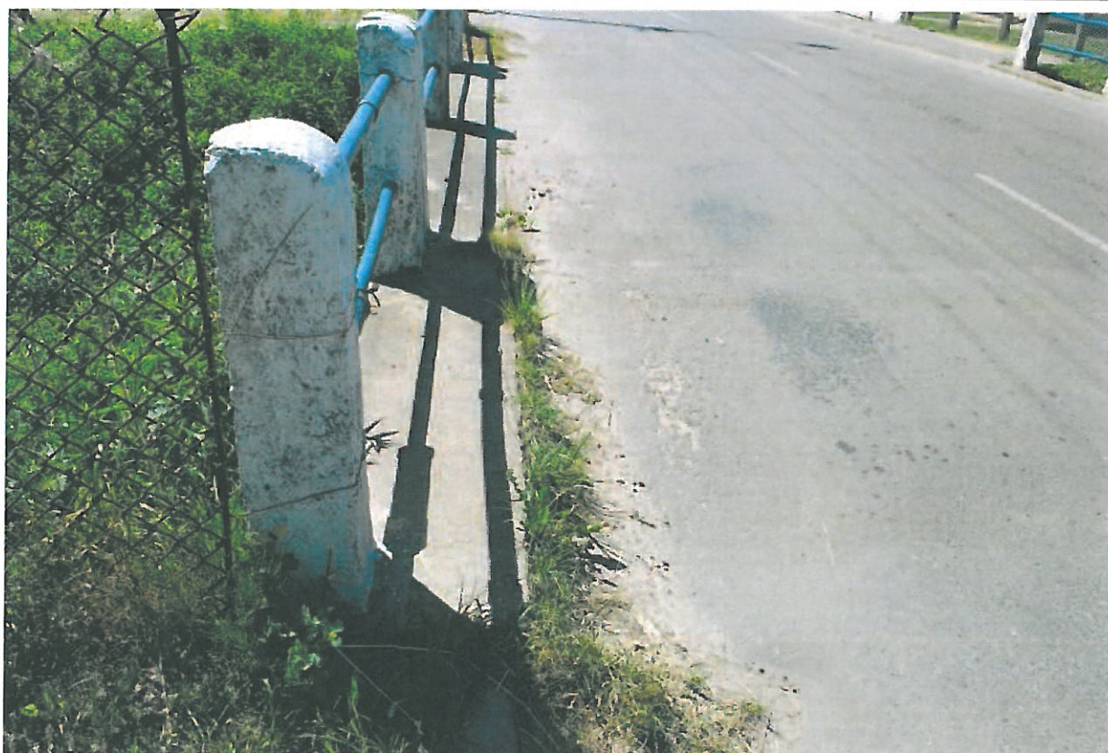
Fot. 14. Widok na nawierzchnię przy kapie zachodniej. Widoczna intensywna wegetacja roślinności wskazuje na brak systematycznych prac utrzymaniowych.
