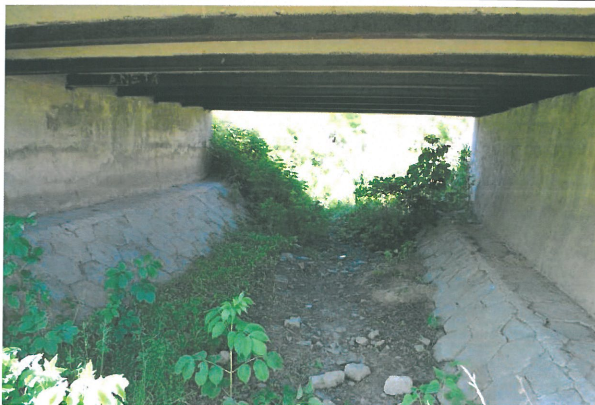
Fot. 12. Widok na przestrzeń podomostową. Widoczna wegetacja roślinności spowodowane brakiem systematycznych prac utrzymaniowych.
