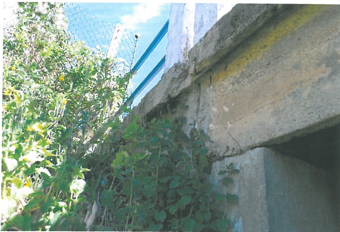
Fot. 7. Widok na wegetującą roślinność oraz ubytki betonu gzymsu po stronie północno - zachodniej obiektu.
