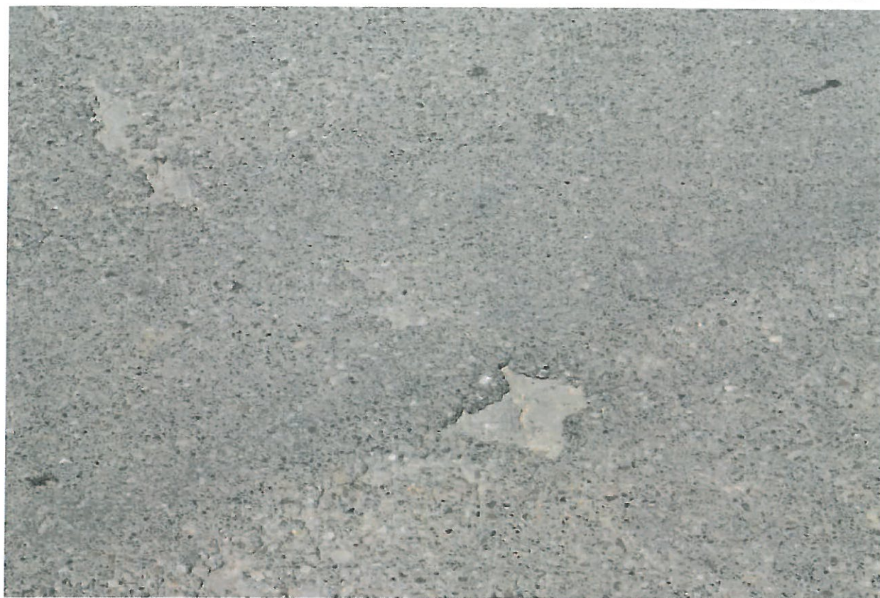
Fot. 15. Widok ubytki i rysy asfaltu w nawierzchni obiektu.
