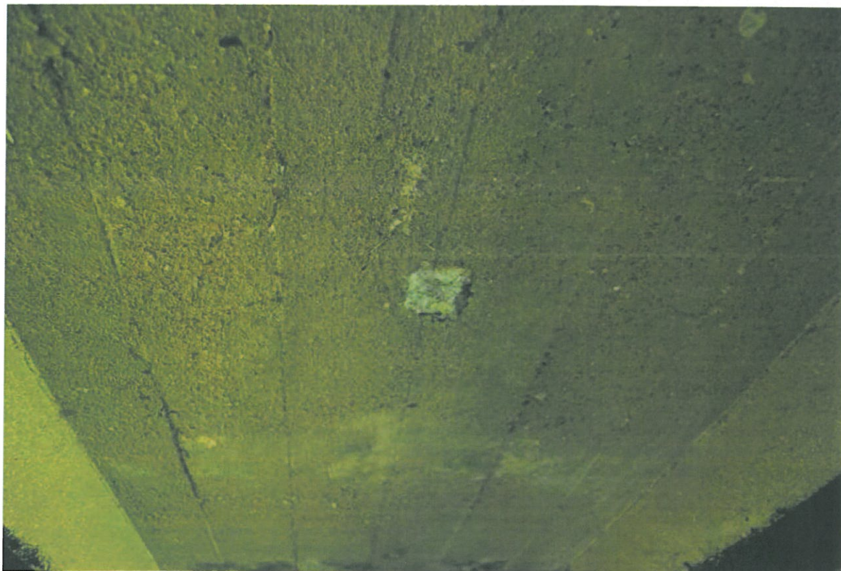
Fot. 10. Widok na konstrukcję pomostu. Widoczne ubytki betonu.
