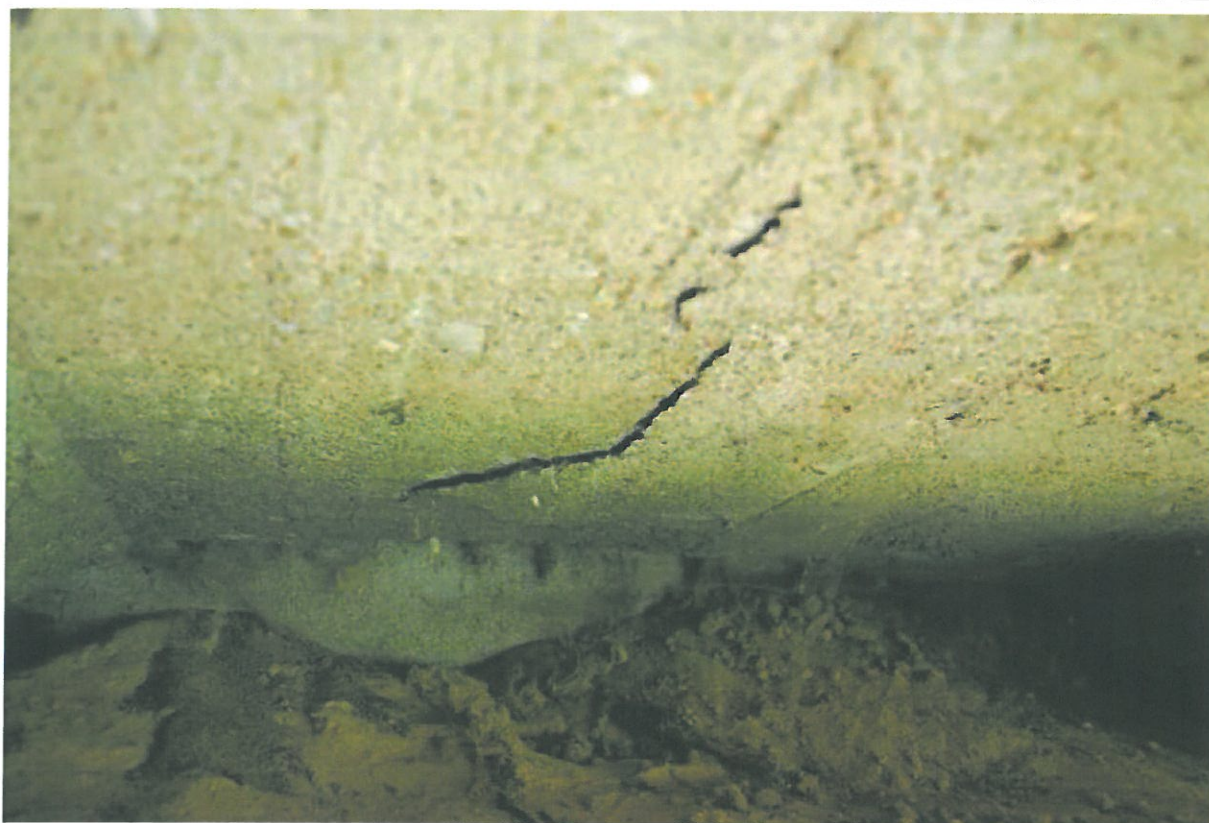
Fot. 11. Widok rysy betonu na konstrukcji pomostu oraz zanieczyszczenie północnej ławy podłożyskowej spowodowane brakiem systematycznych prac utrzymaniowych.
