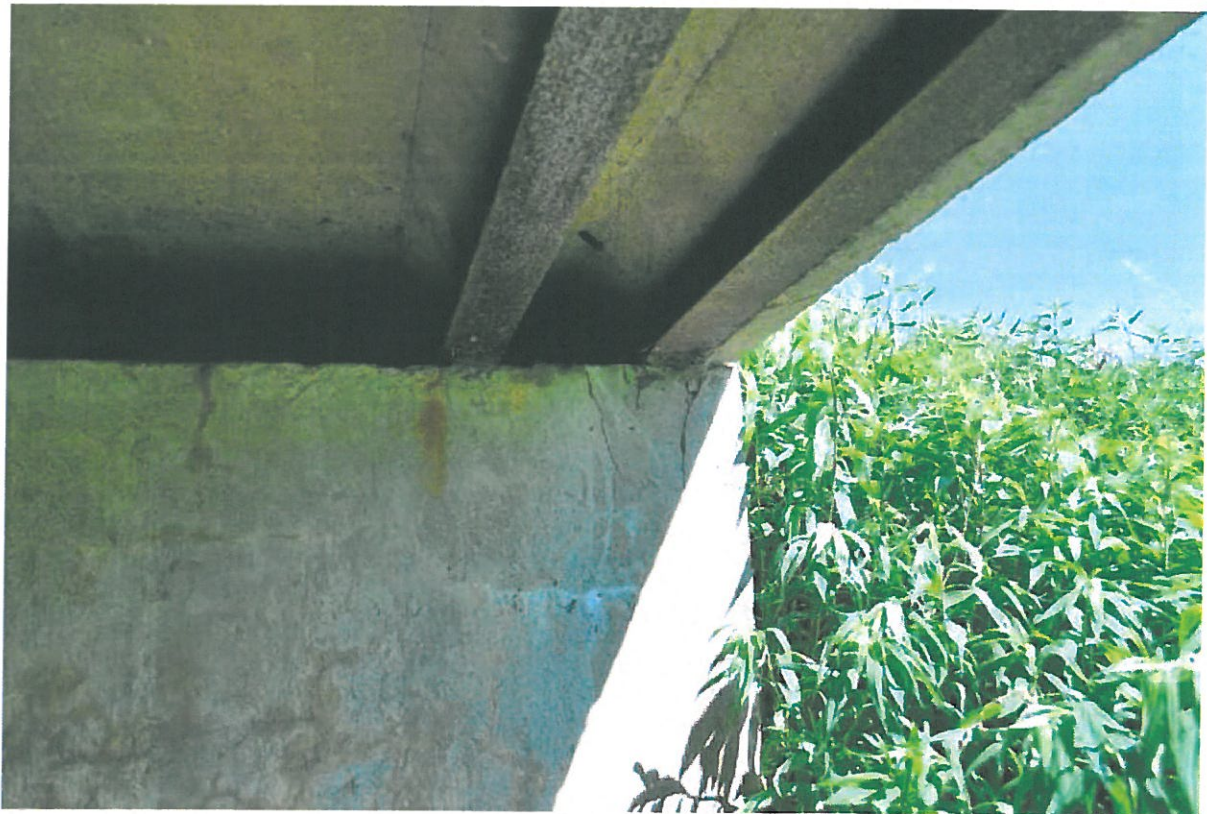
Fot. 5. Widok na przyczółek północny od strony wschodniej. Widoczne rysy betonu.
