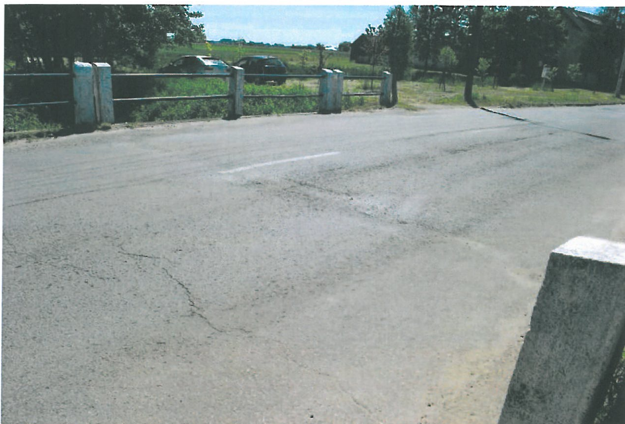
Fot. 13. Widok na dojazd do obiektu od strony północnej. Widoczne rysy w nawierzchni asfaltowej.
